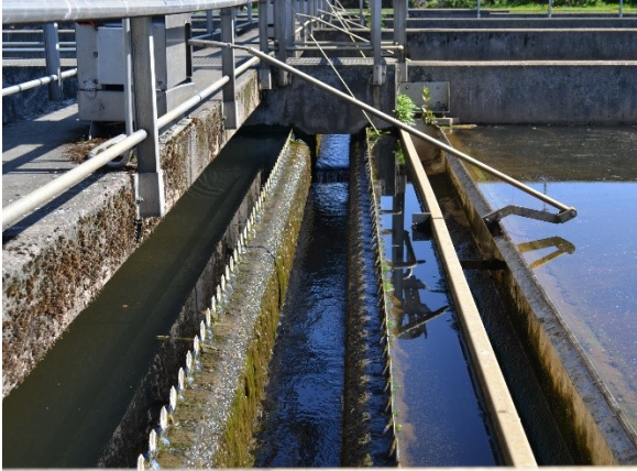
Jälkiselkeytyksaltaan mekaanisia puhdistimia.
